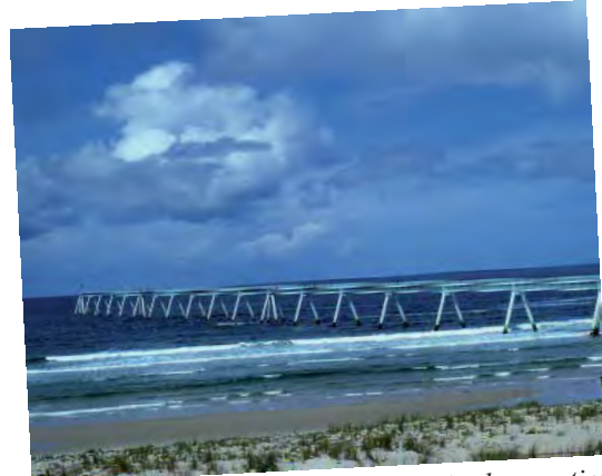
Le Wharf de la Salie, censé résoudre la question de l'assainissement du Bassin d'Arcachon, pose de graves problèmes...
