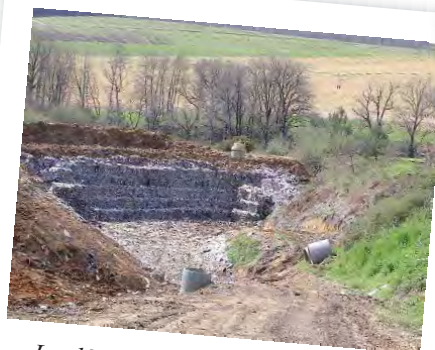
La décharge de Caupenne (40)...
